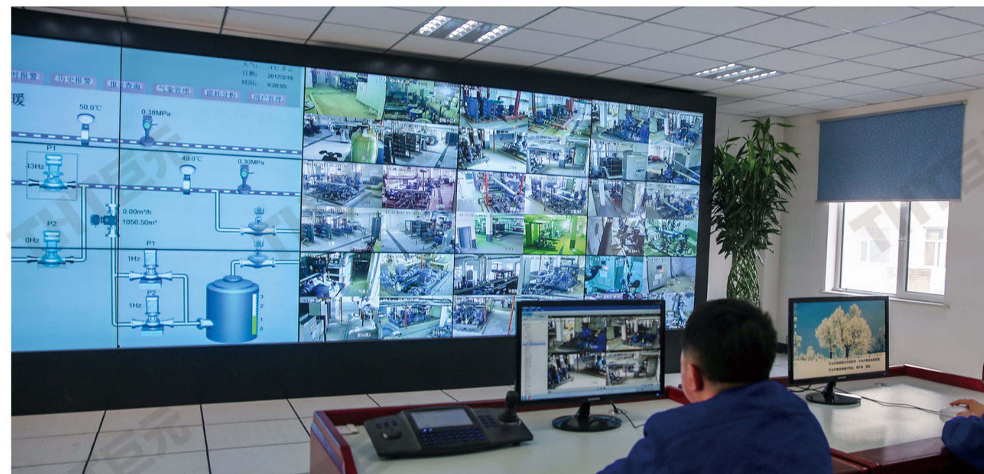
THT巨元SCADA系统
